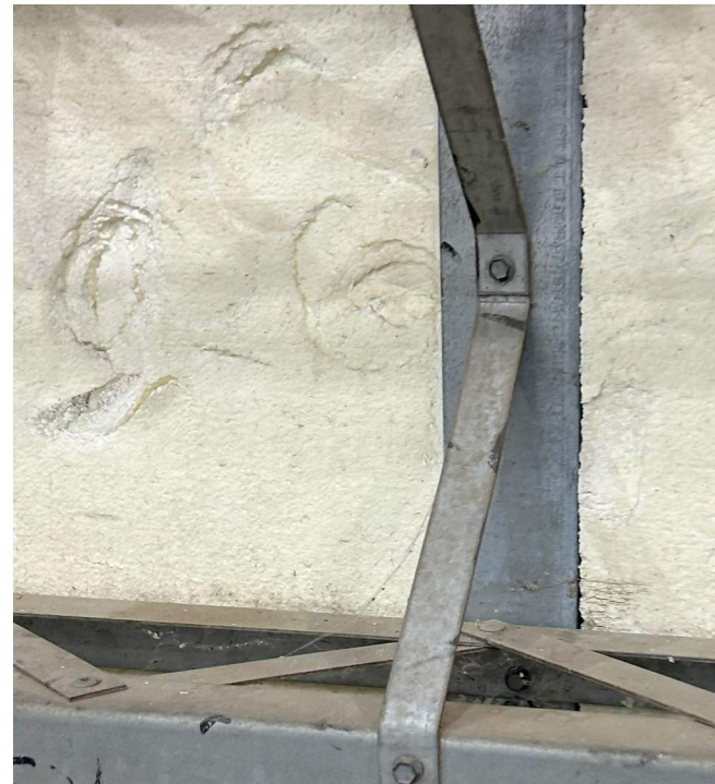
PUCK DAMAGED DOOR
